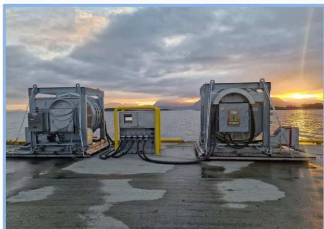
Stangnes, kabeltrommel til Landstrømsanlegget Foto: HHKF
